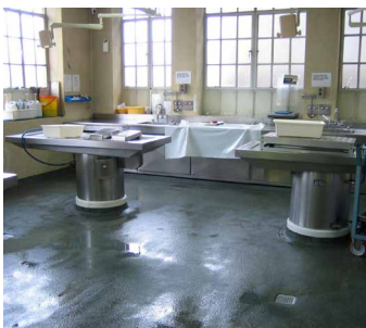
混凝土地面修复前
